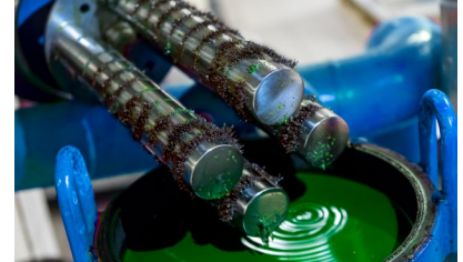
Ein Magneteinsatz im Partikelfilter filtert Magnetitreste und Korrosionsprodukte aus dem Kreislaufwasser.
