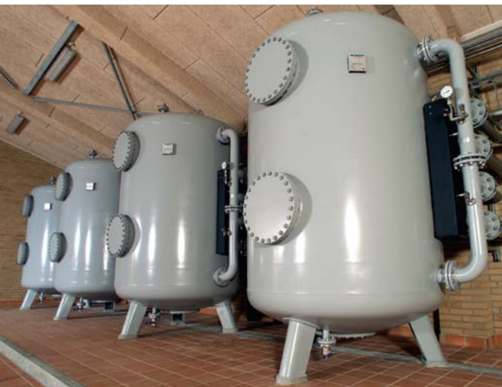
Usuwanie żelaza, manganu i amoniaku w stacji wodociągowej. Przepływ: 2 x 35 m 3 /h.
